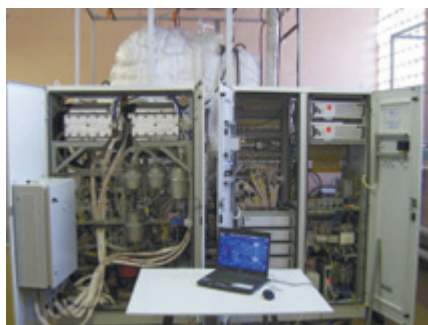
Когенерационная энергоустановка на основе ТПТЭ, работающая на природном газе, мощностью 10 кВт
